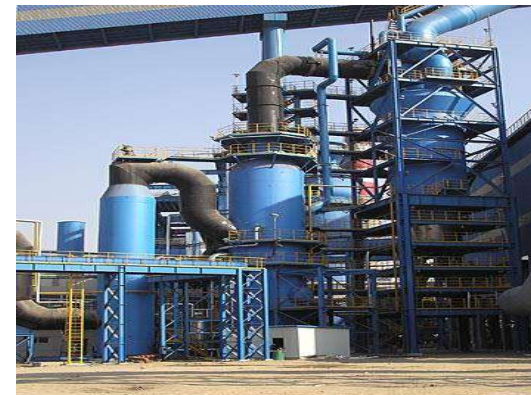
installation d'épuration de gaz de haut-fourneau
