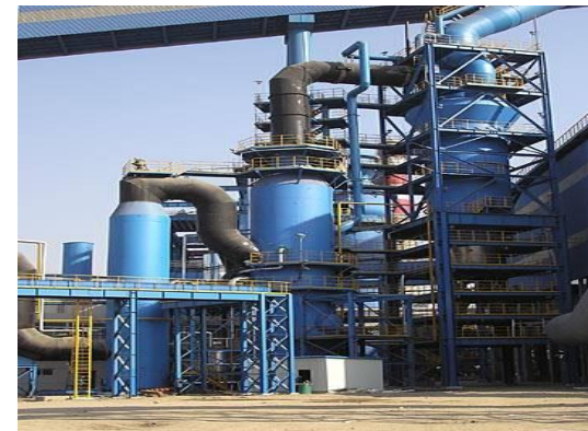
installation d'épuration de gaz de haut-fourneau
